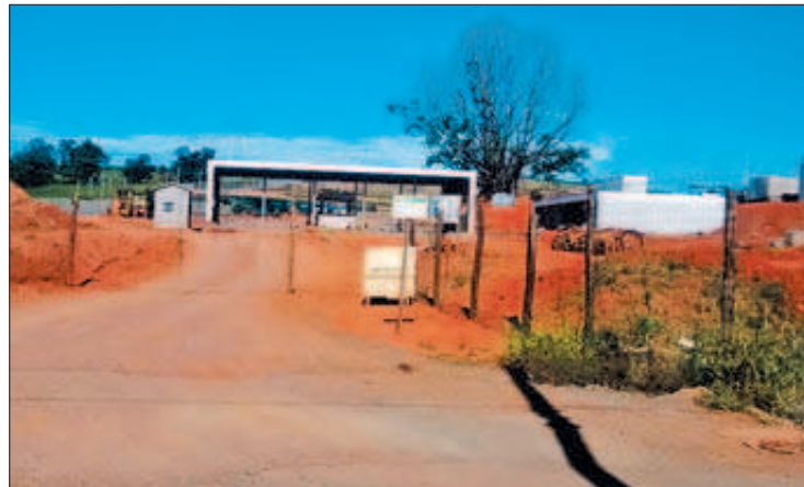
CANTEIRO DE OBRAS onde o motorista Antonio José dos Santos ficou gravemente ferido após caçamba de seu caminhão cair sobre sua cabeça
