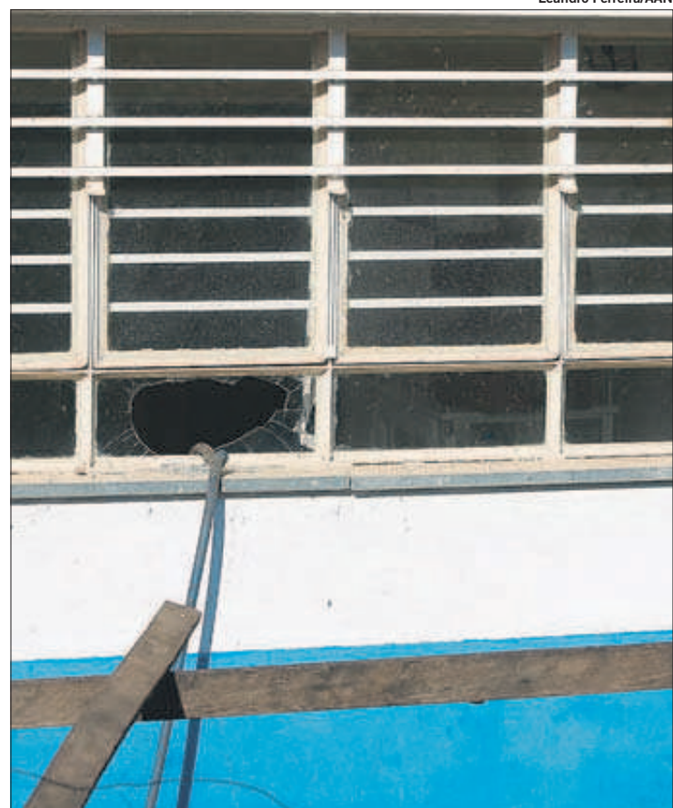
VIDRAÇA quebrada por vândalos que entraram no Centro de Saúde do Jardim Fernanda na madrugada; apesar dos danos, nada foi levado
